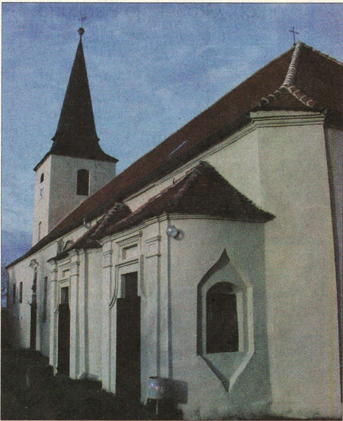
Am Dachstuhl der Angeraner Kirche müssen dringend Schäden beseitigt werden. Foto: Burkhard Steffen
